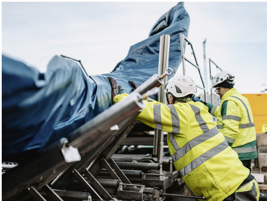
Der Schlauchliner wurde über eine Rutsche in die Baugrube geführt. | Foto: D&S
